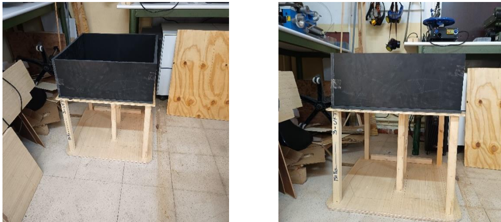
Figure III-7 Montage du bac de plantation en Forex noir construit dans le fab-lab
