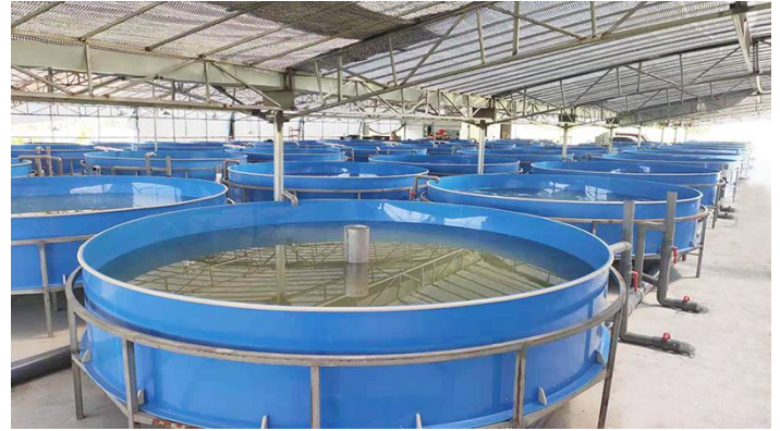
Figure I-8 Les bassins en matériau plastique
