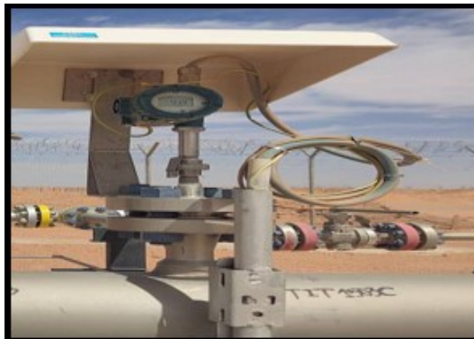
Figure 2.32: Transmetteur de température
