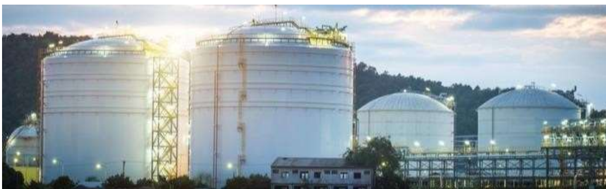
Figure 1-15 : les bacs de stockage des hydrocarbures [25]
