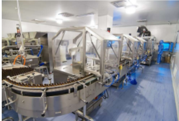
Figure 1.35: Système automatique pour la production pharmaceutique [3]
