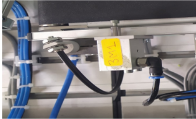
FIGURE 2.43 – Module de barrage de la station.
