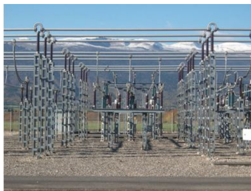
FIGURE 2.17: Jeux de barres de puissance
