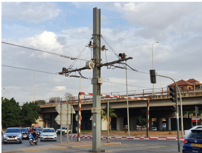
FIGURE 3.20: Point d'injection à la LAC à-côté d'une sous station
