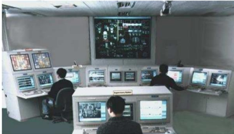
Figure 2.5: Poste pilotage d'une supervision
