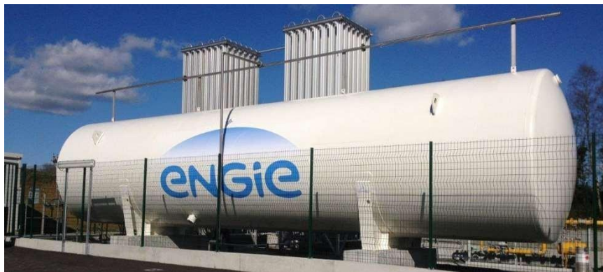
Figure 17:Les réservoirs du biogaz Liquéfié[13]
