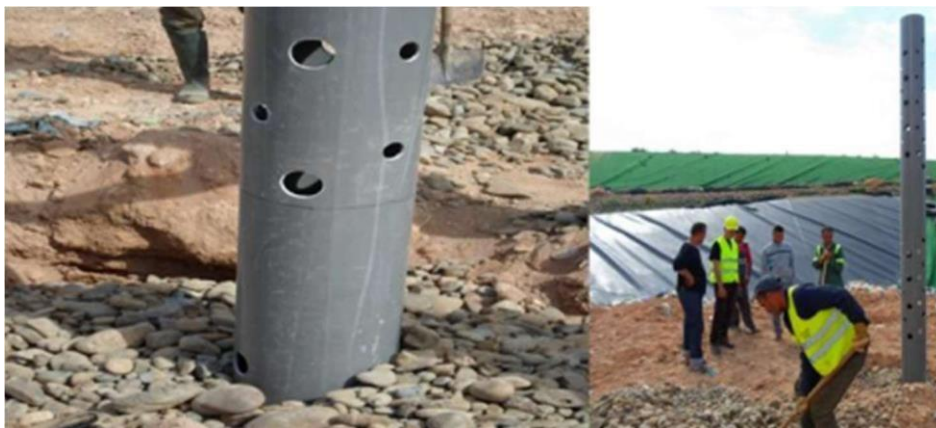
Figure 19: Système de récupération du biogaz[15]
