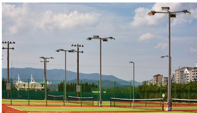
FIGURE 1.5: Éclairage des espaces sportifs
