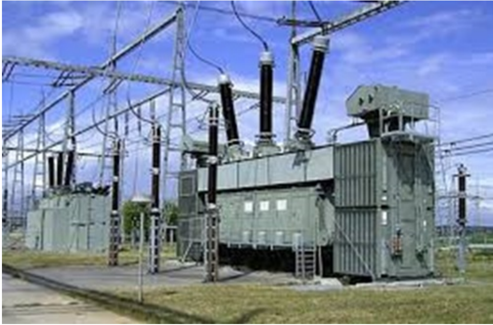
FIGURE 1.13 – Transformateur de puissance dans un poste de transformation
