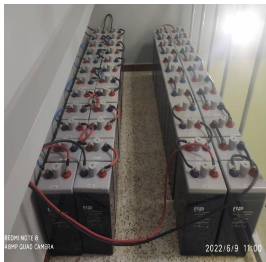
Figure 66 : Le raccordement des batteries (2*24).
