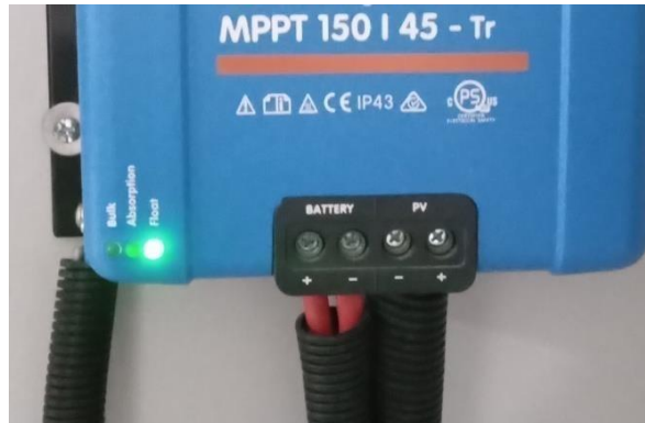
Figure 65 : le branchement du régulateur de charge.
