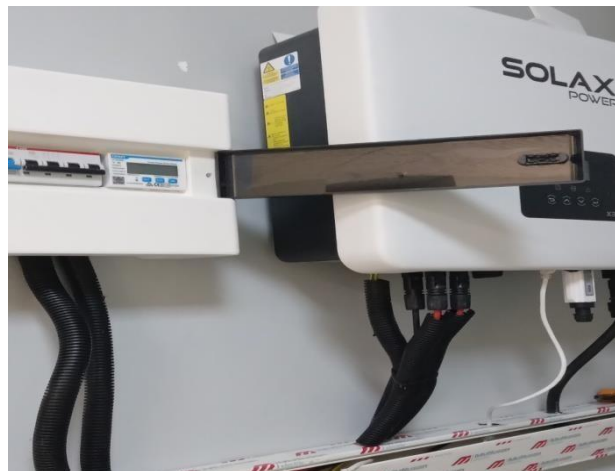
Figure 91 : couplage de l'onduleur et le smart mètre (le câble blanc RS485).
