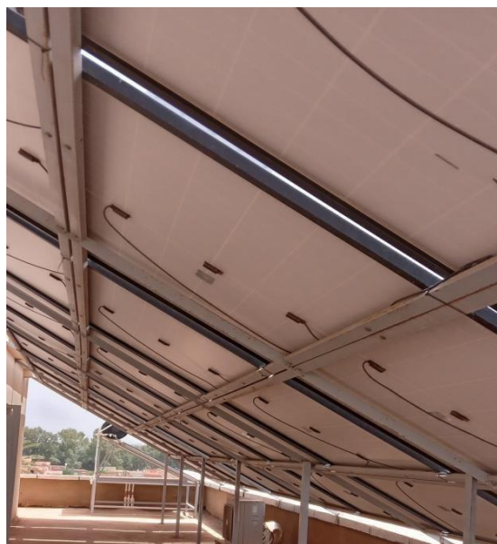
Figure 84 : Résultat de l'installation PV (2 * 18).
