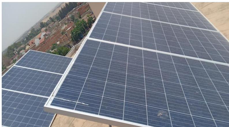
Figure 61 : 9 modules installés avec une pente de 32 degrés.
