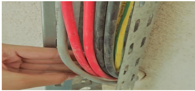
Figure 88 : Les câbles sortant du central.
