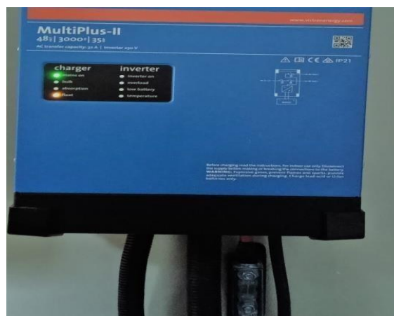
Figure 67 : l'entrée à droite en DC et la sortie AC du convertisseur.
