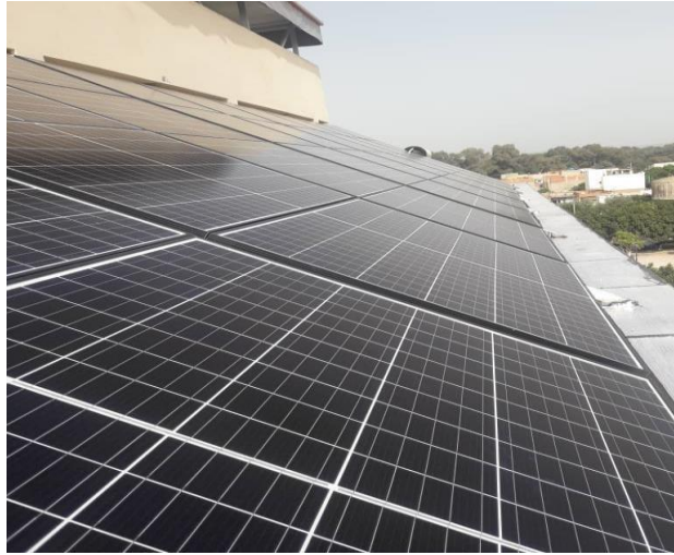
Figure 85 : la centrale photovoltaïque finie (2 * 18).
