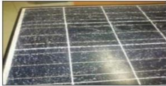
Figure I.16 : Dégradation de module photovoltaïque par des bris de verre [8]
