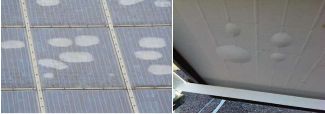
Fig 3.3 : Encapsulation décollément d'un module PV (delamination).
