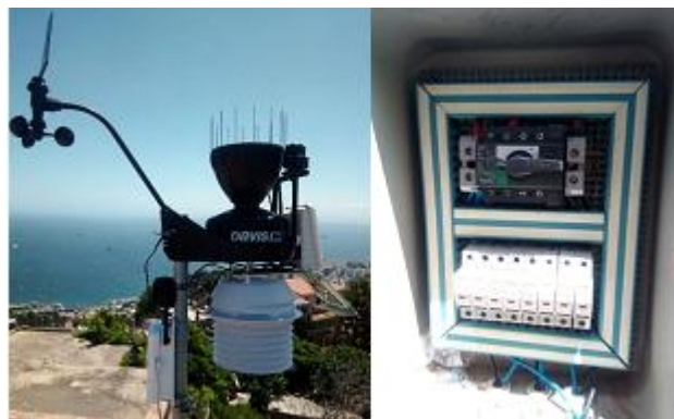
FIGURE IV-15 LA STATION DE MESURE EN TEMPS REEL ET LA BOITE DE JONCTION DU CHAMP PV.
