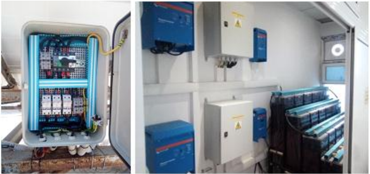
FIGURE IV-25 LA BOITE DE JONCTION ET PARC DES BATTERIES DE LA CENTRALE.
