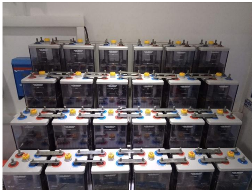
FIGURE IV-17 PARC DE BATTERIE.
