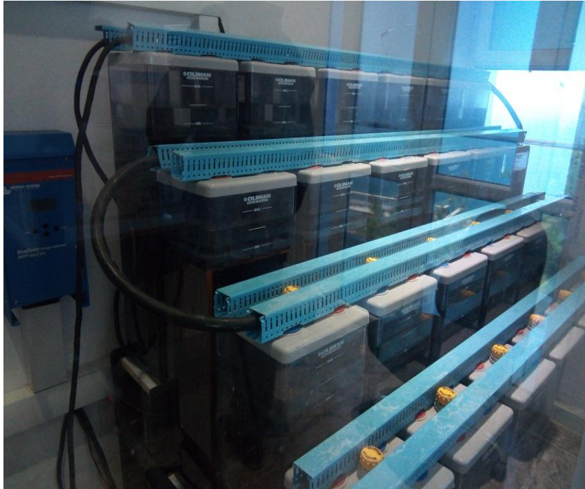
FIGURE III-3 BANC DE BATTERIES POUR UN SYSTEME PV AUTONOME.
