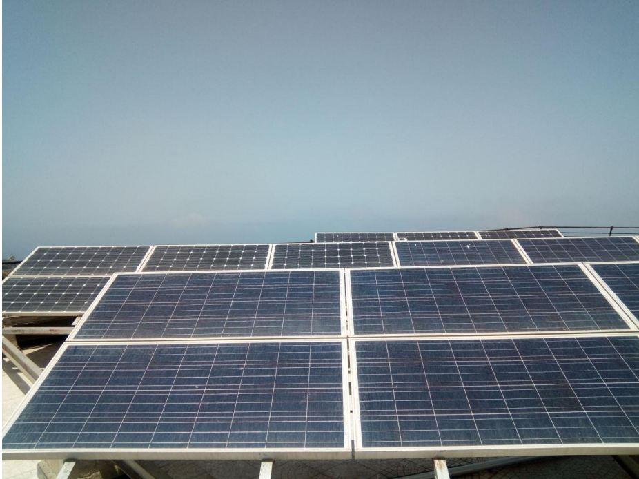
FIGURE IV-23 UNE VUE DE FACE DU CHAMP DE LA CENTRALE.
