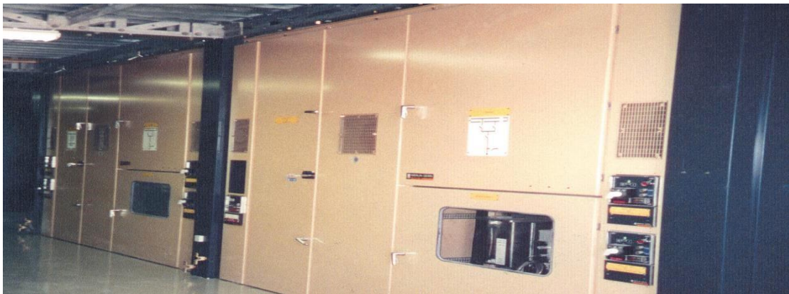
Figure II.5 : Un poste HT isolé à l'air
