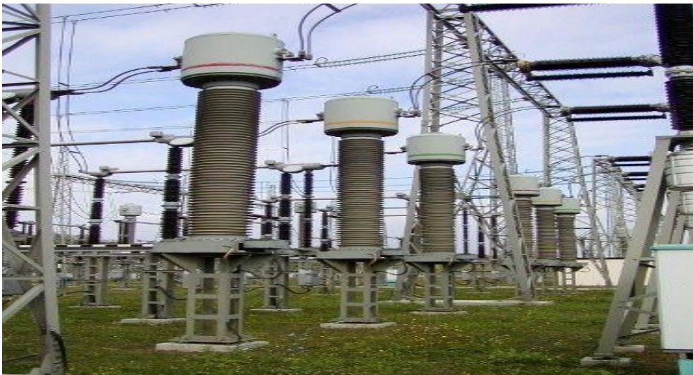
Figure II.10 : Transformateurs de courant au sol
