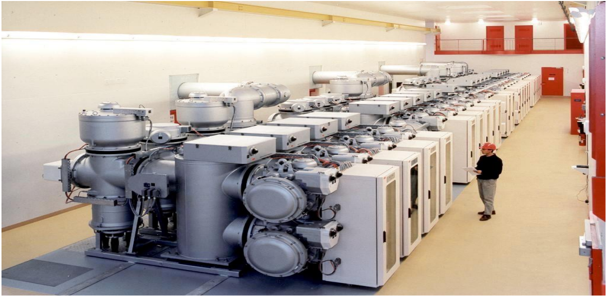
Figure II.4 : un poste HT isolé au SF6
