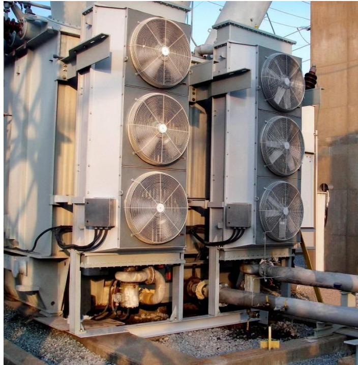
Figure II.8 : transformateur refroidi par circulation forcée d'huile
