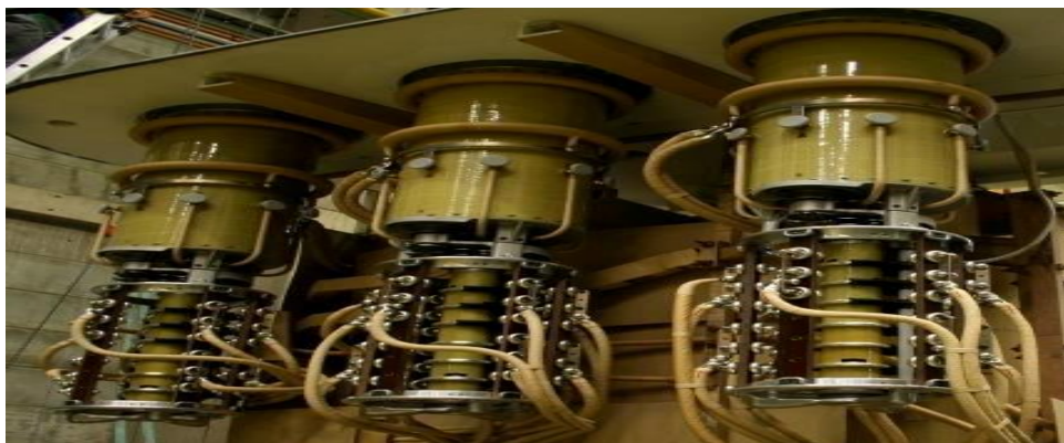
Figure II.6 : Changeur de prise
