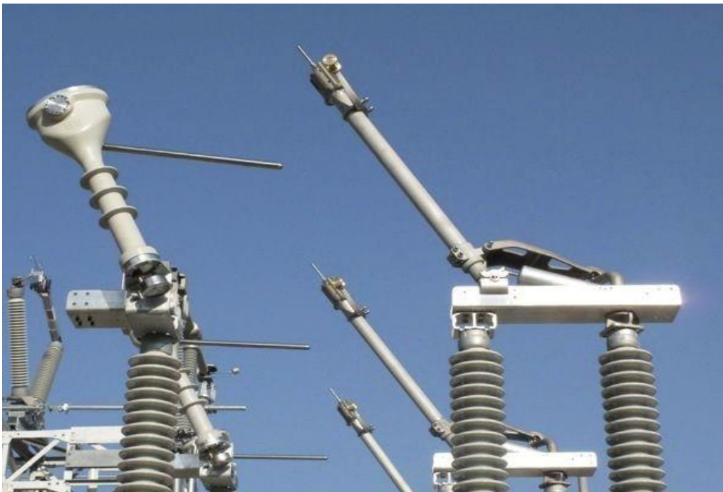
Figure II.14 : Sectionneur haute tension ouvert
