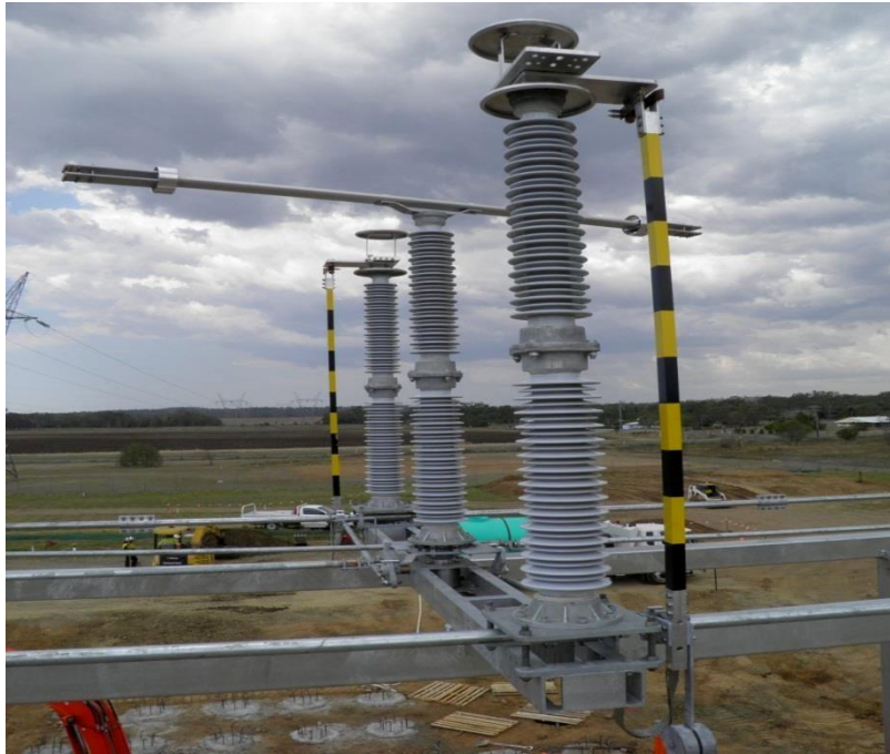
Figure II.15 : Sectionneur de mise à la terre
