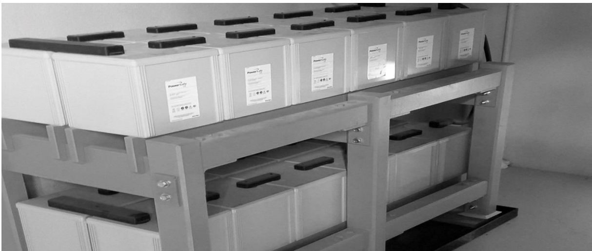
Figure II.17 : Jeu de batteries stationnaires
