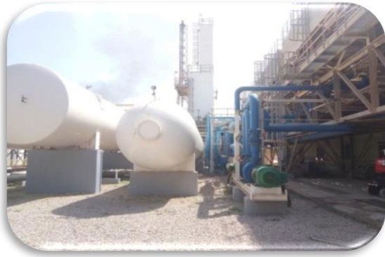
Figure 14: bac de stockage d'azote
