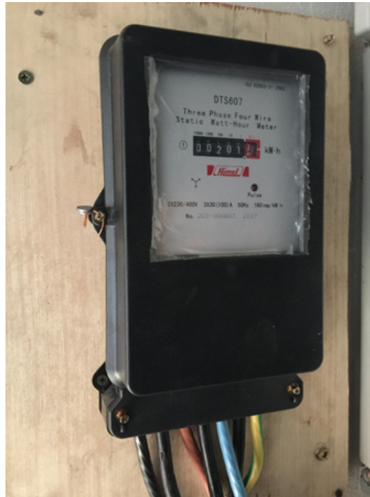
FIGURE III.4 – Compteur d'énergie électrique Himel DTS607 pour la mesure sur le site
