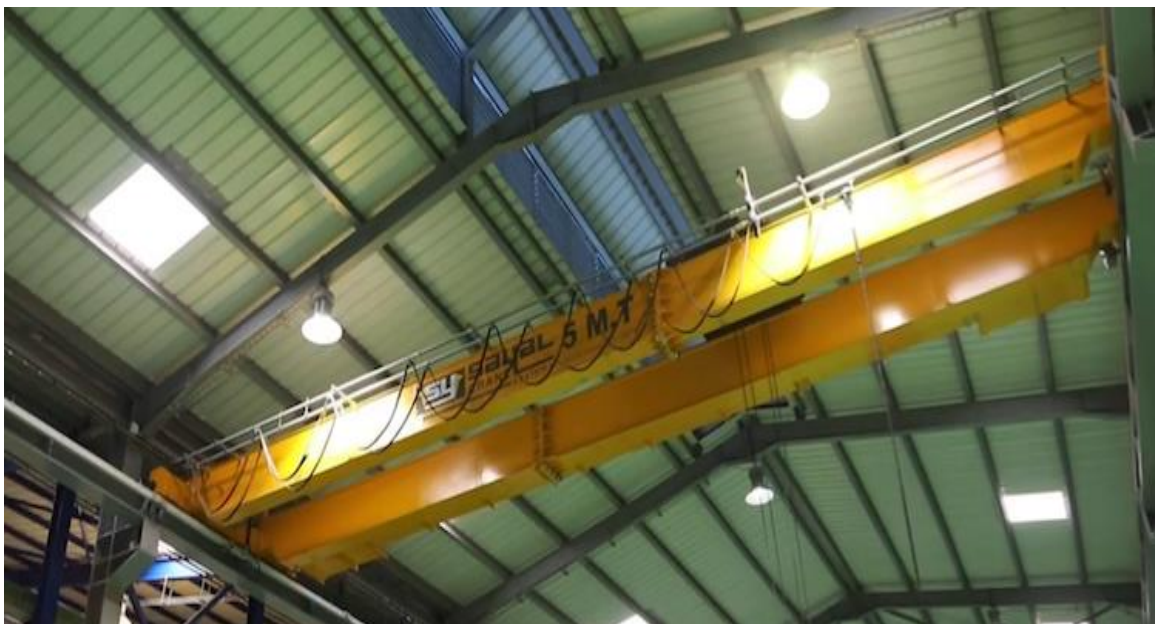
Fig.I.15 : Pont roulant bipoutre de l'atelier de transformation métallique.
