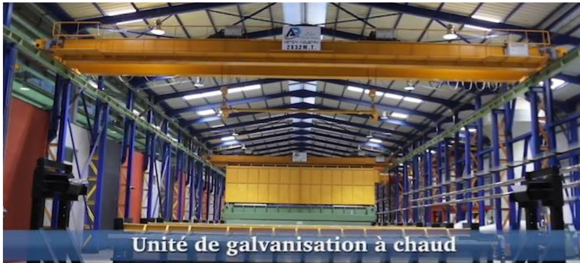
Fig.I.14 : Pont roulant bipoutre de l'unité de galvanisation à chaud.
