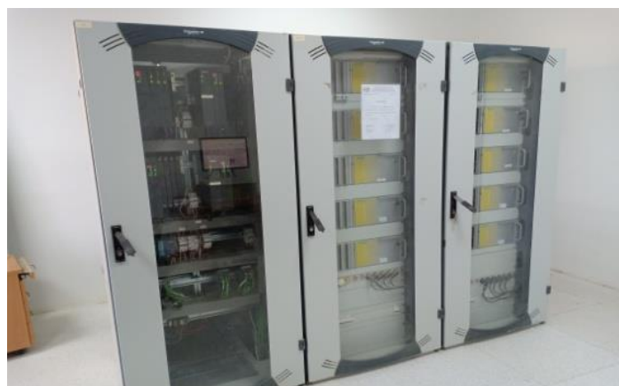
Figure II.39 : Armoire de commande
